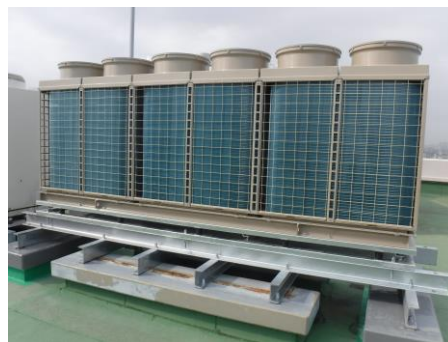
(改修後) 室外機 (高効率)
