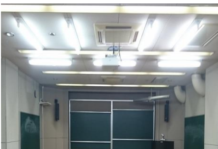
(改修前) 蛍光灯
