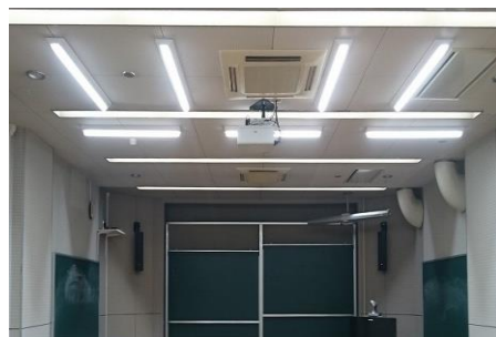
(改修後) LED照明
